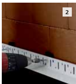
2 Das Sto-Startprofil PH-K waagrecht mit Sto-Schlagdübeln S UEZ 8 / Sto-Schraubdübel S UEZ 8 (Hohlziegel) befestigen. Jede Leiste im äußersten Loch befestigen. Abstand der Befestigungsmittel ca. 30 cm. Am Stoß den Sto-Sockelleistenverbinder durchgängig einbauen. Wandunebenheiten mit Sto-Unterlegscheiben ausgleichen. Den Spalt zwischen Startprofil und Wand mit Sto-Pistolenschaum SE schließen. Im Eckbereich Startprofil auf Gehrung schneiden.
